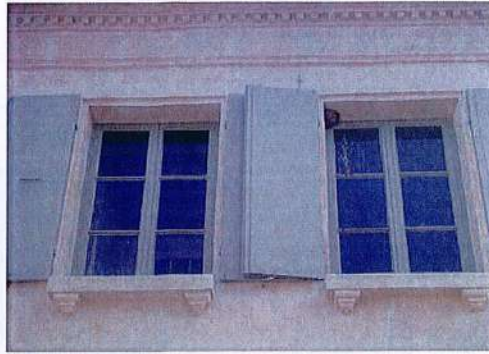
Corniche avec denticules, appuis de fenêtre et feuillure en pierre de taille avec joints à la chaux arasés au nu de la pierre
