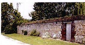
Mur de pierre en blocage avec chaînes et couronnement en brique avec bande herbeuse
