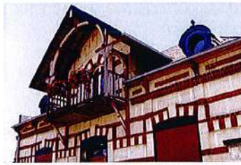
Lucarne centrale avec débord de toiture, boiseries peintes, balcon, lucarne œil de bœuf
